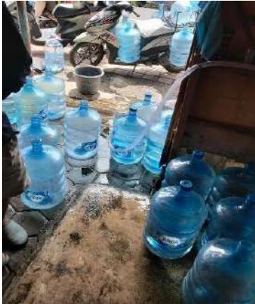
Kondisi lantai di area pengisian air minum isi ulang di pulau kawo
