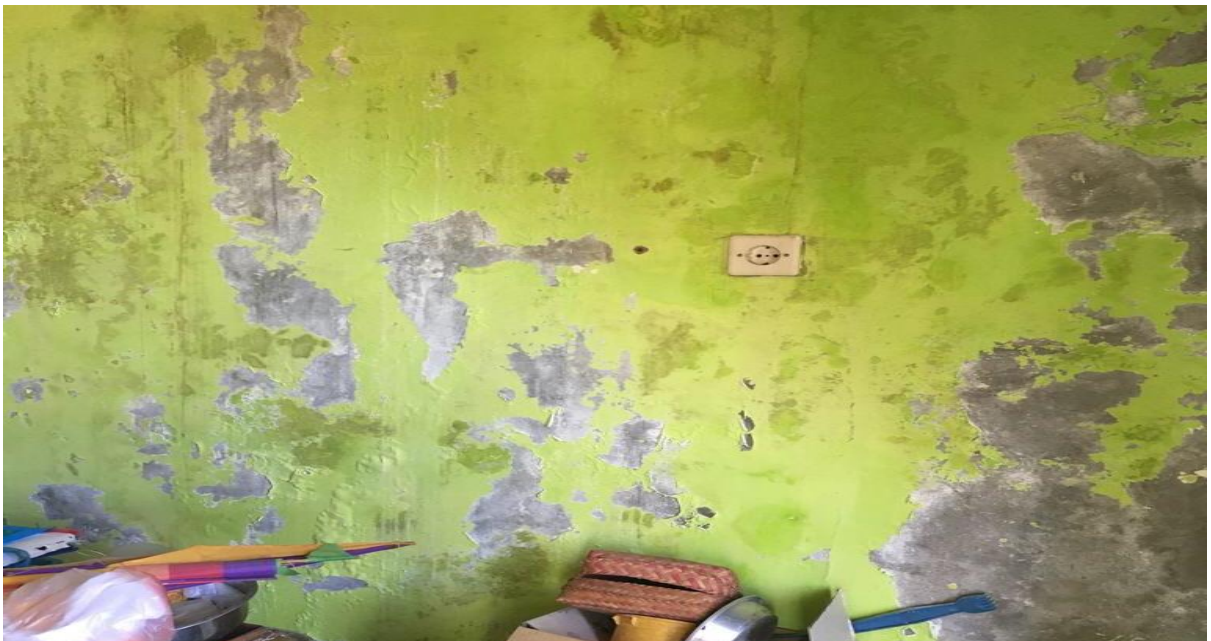
Keadaan dinding salah satu rumah warga di Desa Tegal Harum
