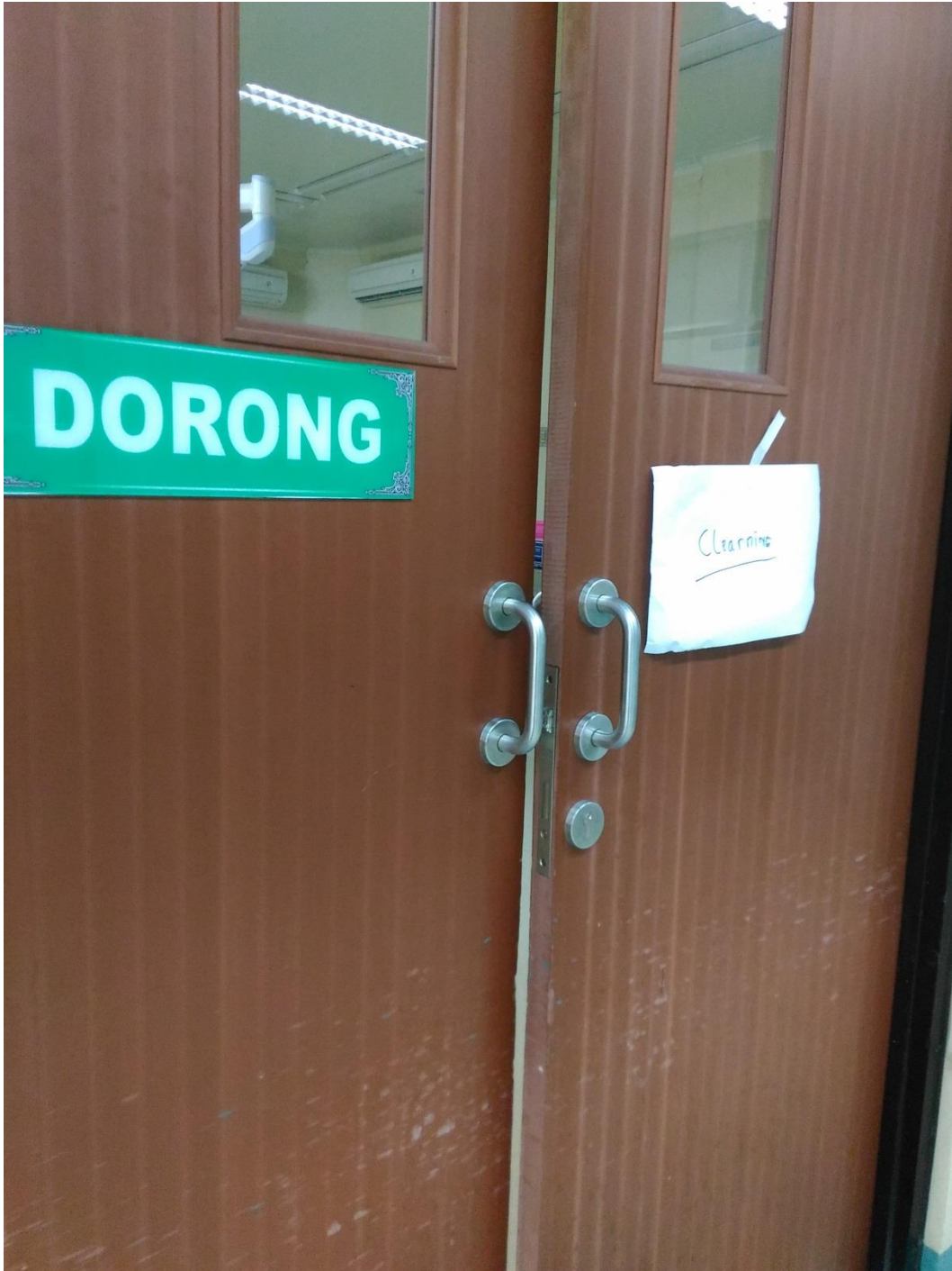
Kondisi pintu ruang operasi yang rusak (tidak bisa ditutup rapat)
