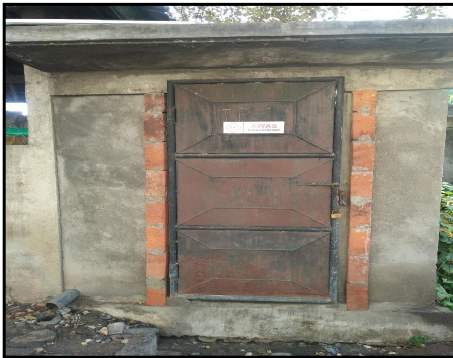
Bangunan TPS Limbah Medis Padat
