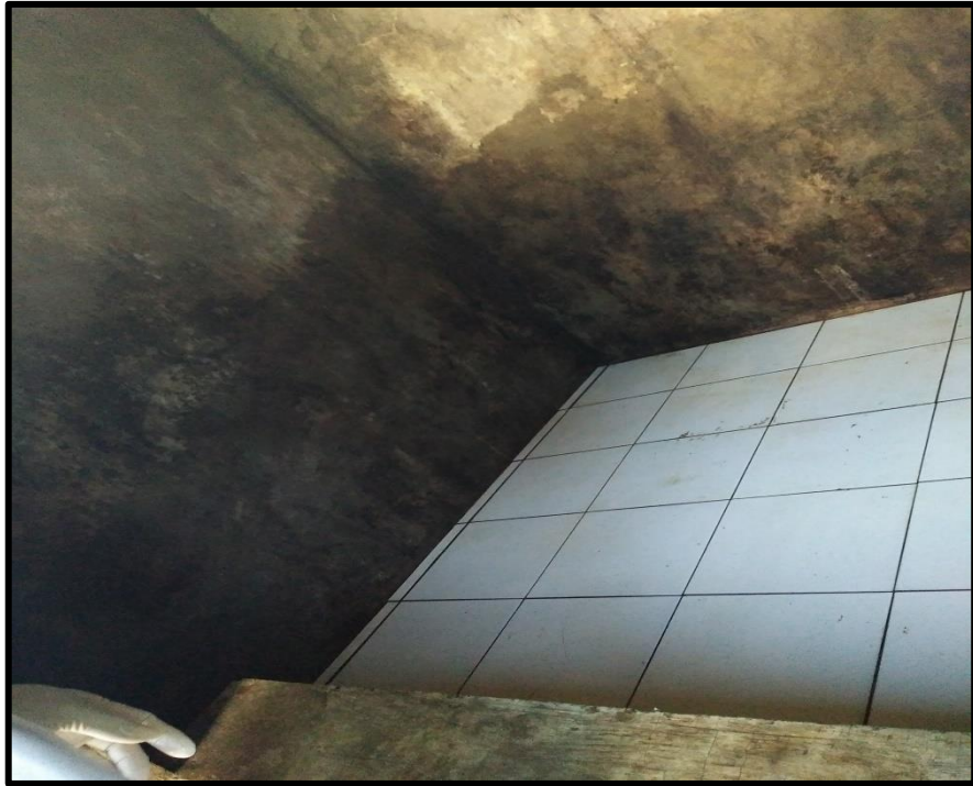
Keadaan Lantai Bangunan TPS Limbah Medis
