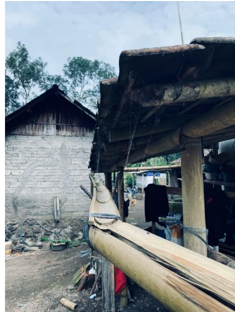
Gambar 2 Kondisi Talang Air
