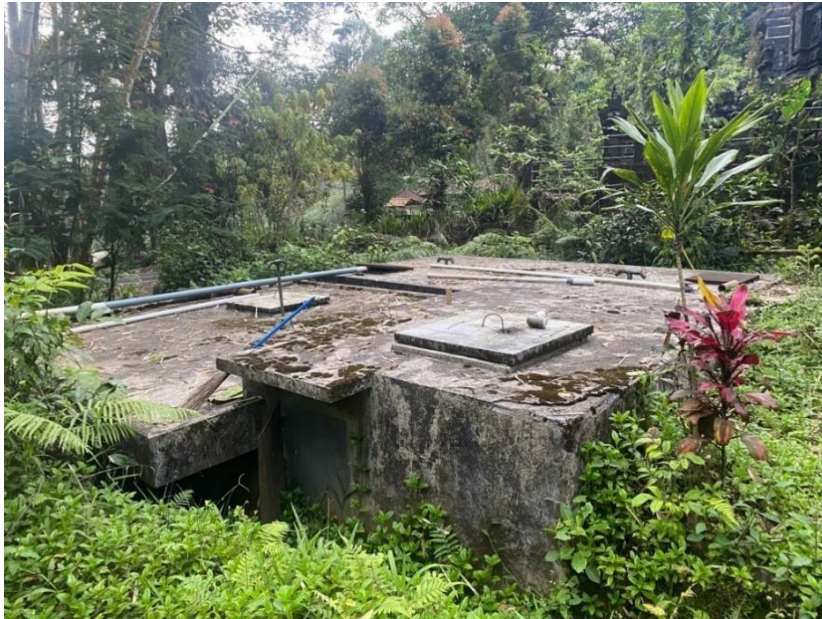
Kondisi Reservoir PMA Pangkung Tuka Desa Wongaya Gede
