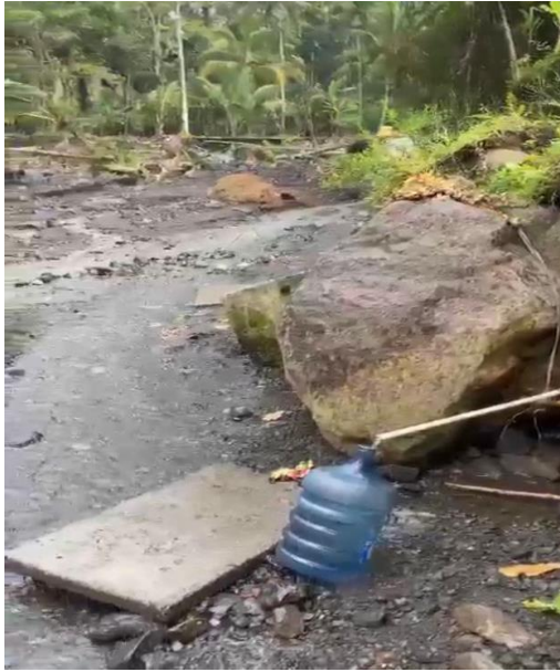
Kondisi Konstruksi Perlindungan Mata Air Jepun Setelah banjir
