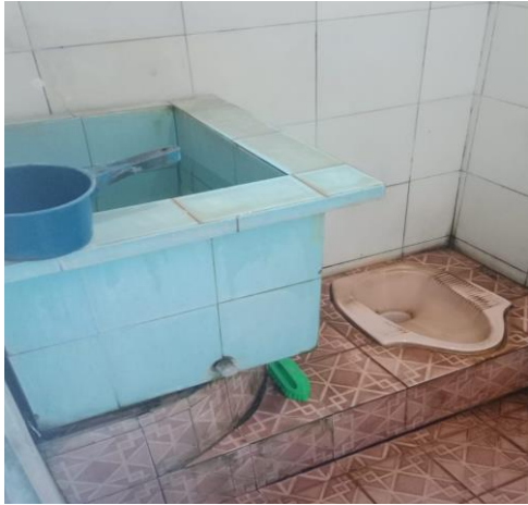
Kedaaan kondisi fasilitas sanitasi terkait toilet umum pada pantai Yeh Gangga
