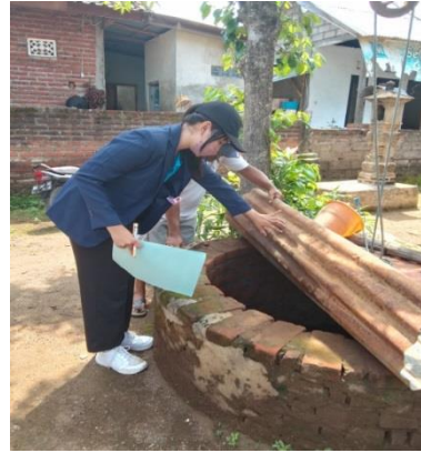
Kondisi penutup sumur gali yang menggunakan seng
