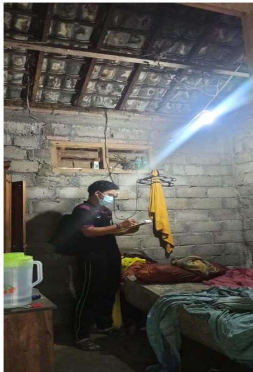
Survey kondisi langit-langit kamar tidur penderita ISPA
